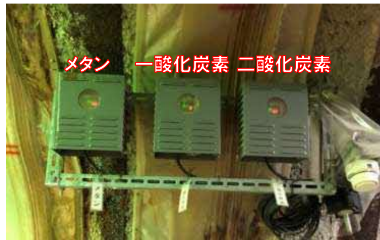
地下の環境を監視するセンサー
